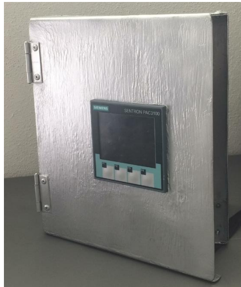
Figura 59. Resultado final del gabinete eléctrico con Sentron PAC 3100.
