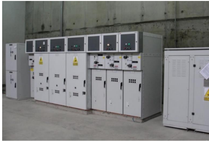
Figura 5. Subestación eléctrica tipo compacta dentro de una industria.
