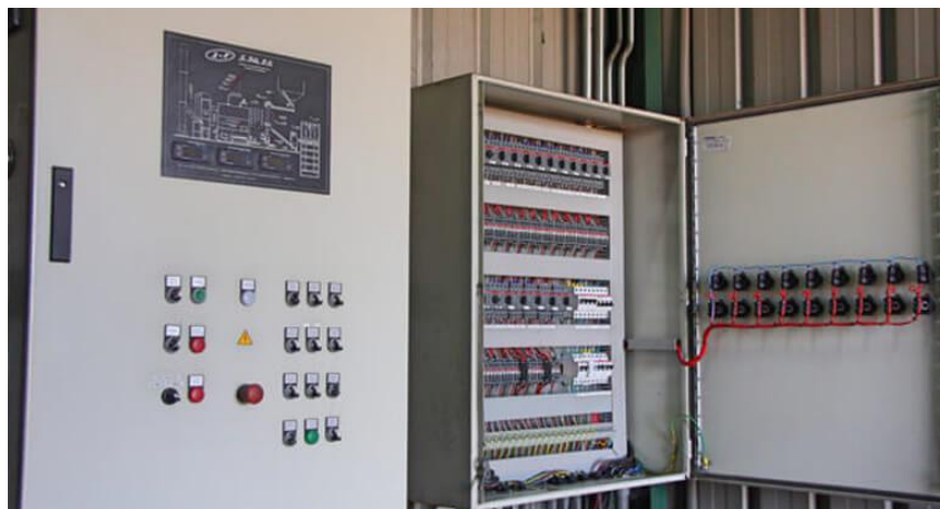
Figura 6. Subestación perfectamente instalada con su conexión eléctrica con su correcto enrutamiento.
