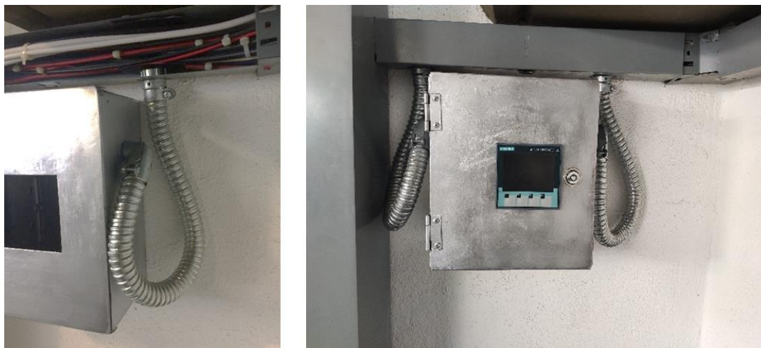
Figura 60. Gabinete de control instalado: adaptado a la canaleta (izq.) y empotrado a la pared (der.)
